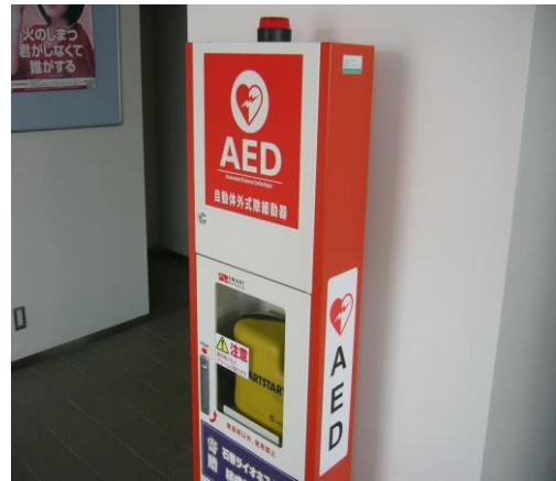
石巻地区消防本部設置状況
