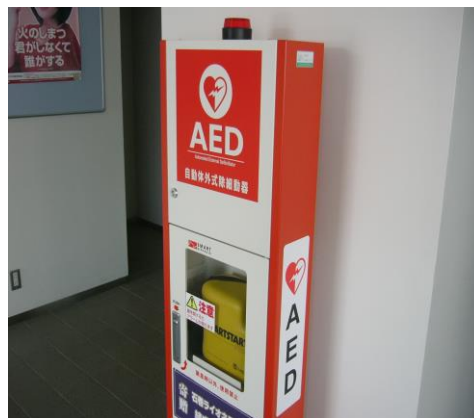
石巻地区消防本部設置状況
