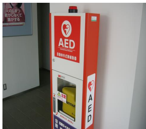
石巻地区消防本部設置状況
