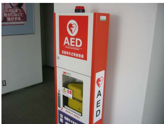
石巻地区消防本部設置状況
