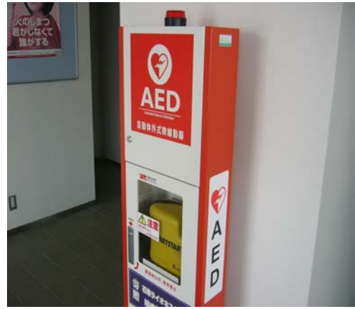
石巻地区消防本部設置状況
